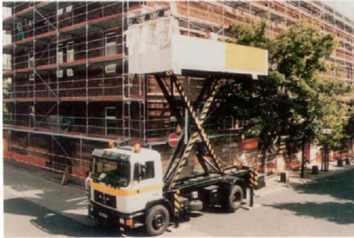
Scherenhubbühne mit automatischer Abstützung.
